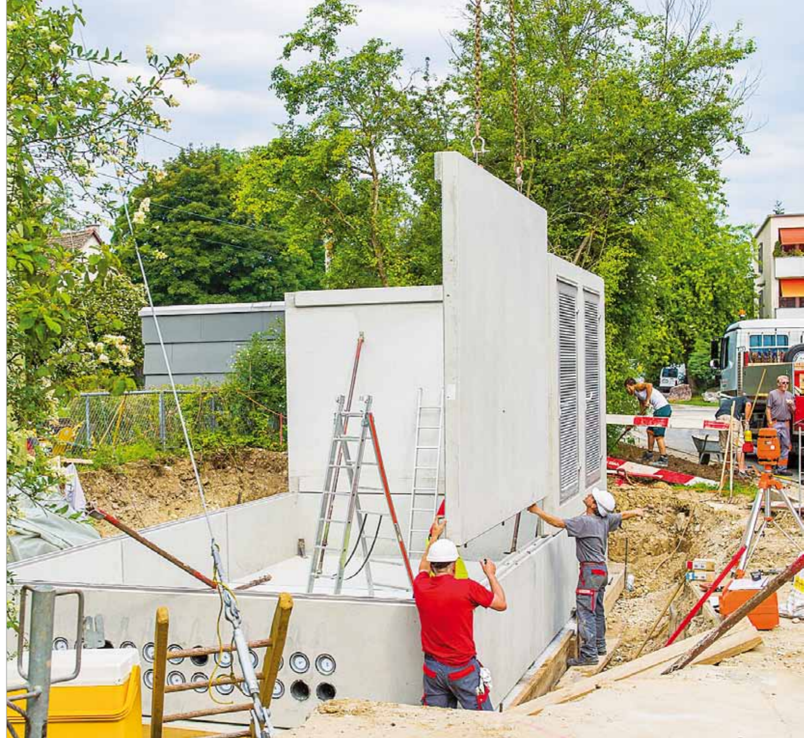
Neue Transformatorstation Unterhub
