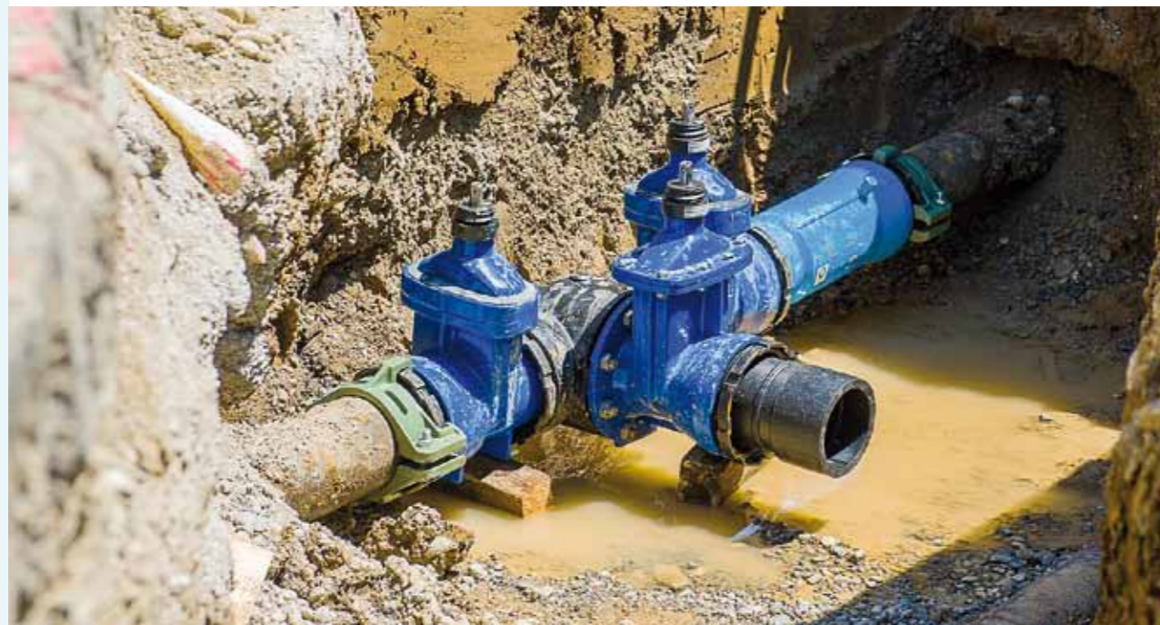
Neue Verzweigung (Schieberkreuz) im Wasserverteilnetz
