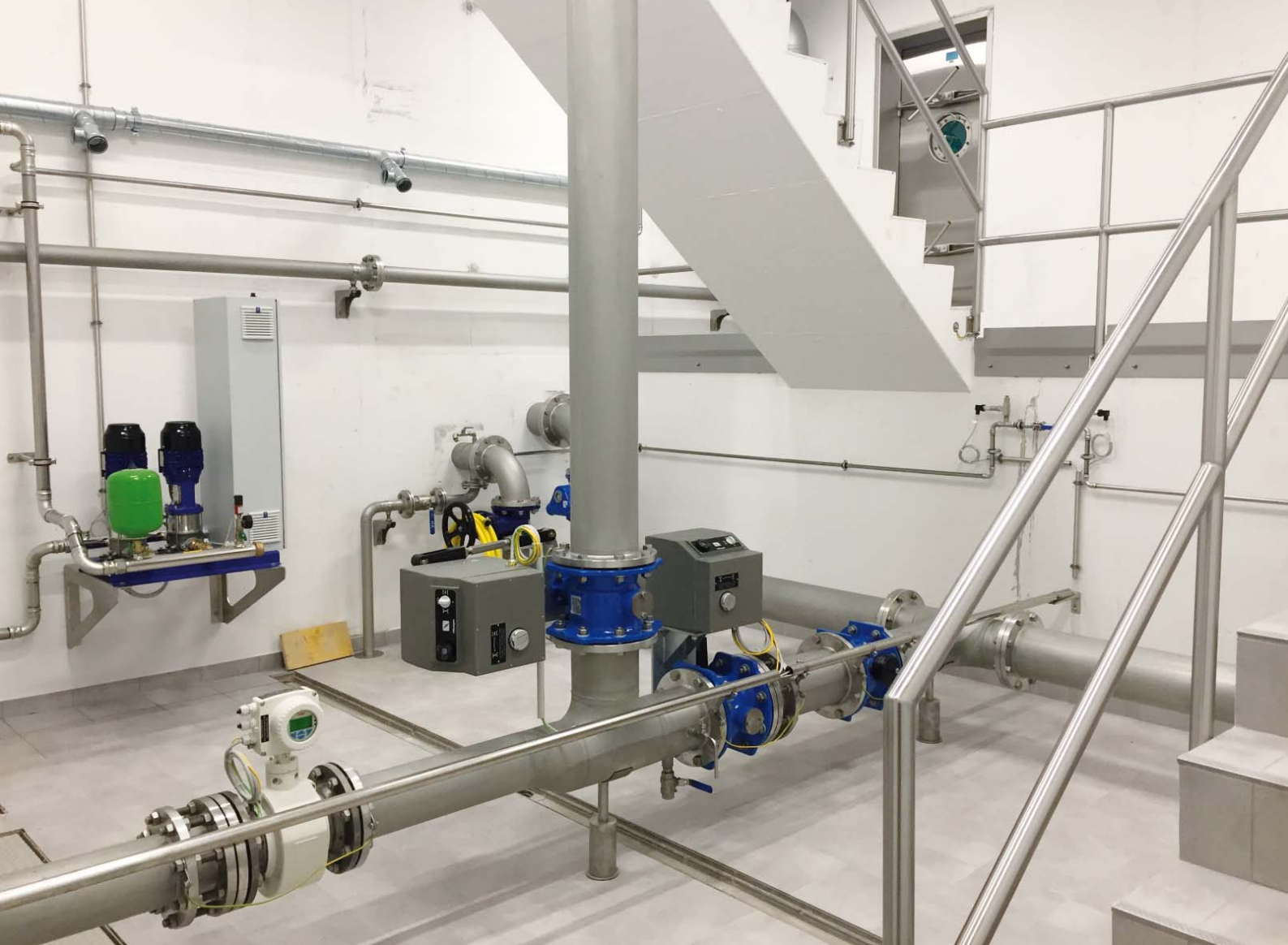
Rohrkeller neues Reservoir Wolentberen
